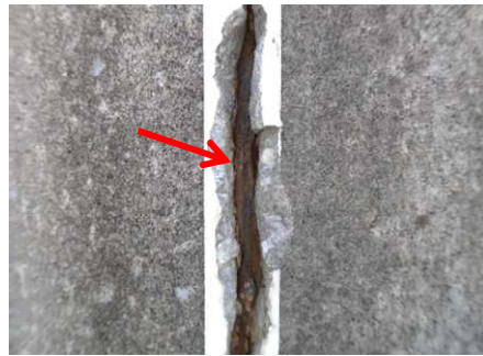
■ 内部鉄筋の腐食
