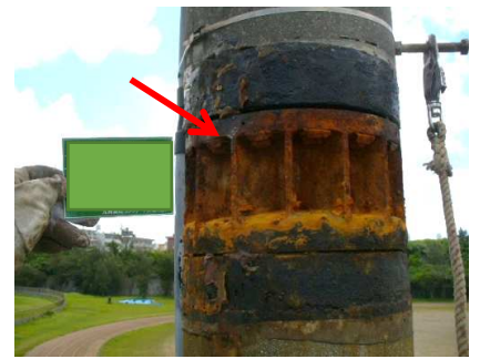
■ 継手部の発錆
