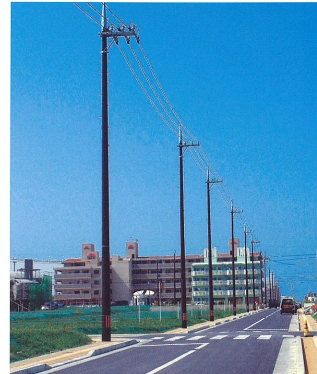
▲電力・通信線用ポール
